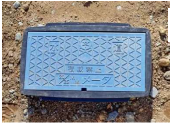
←水道メーター（量水器）です
